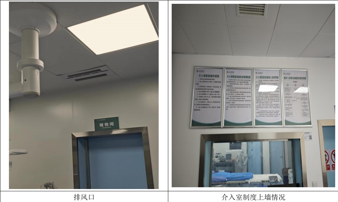
图 3-7 DSA 机房排风系统及制度上墙情况
